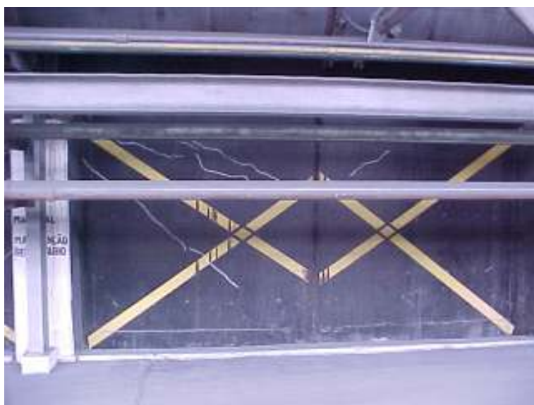
FIGURA 3.7 – Trincas na parede devido ao efeito térmico
