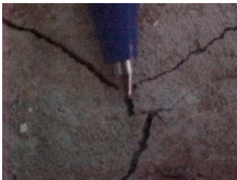
FIGURA 3.9 – Detalhe da trinca no contorno do pilar
