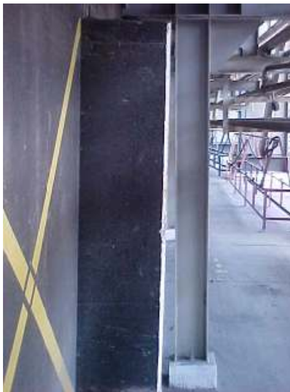
FIGURA 3.4 – Parede de concreto armado deformada
