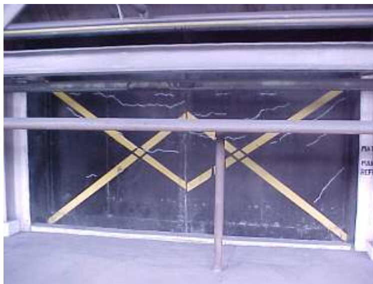
FIGURA 3.8 – Trincas na parede devido ao efeito térmico
